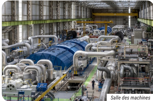
Salle des machines
